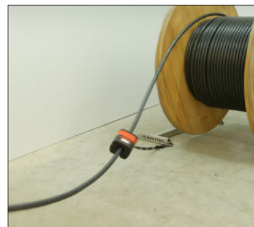
RM35 s odvíječem RUNPOLIFTER 4500 a kabelem 1 x 300 mm 2
